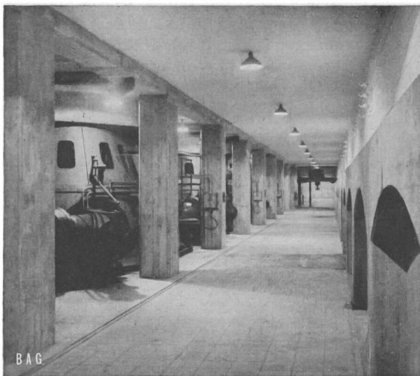
Fig. 17. Turbinenvorraum mit direkter Deckenbeleuchtung (Siehe auch Fig. 6.)
