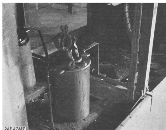
Fig. 8 Zerstörter 16-kV-Ölstromwandler im 1. Stock
