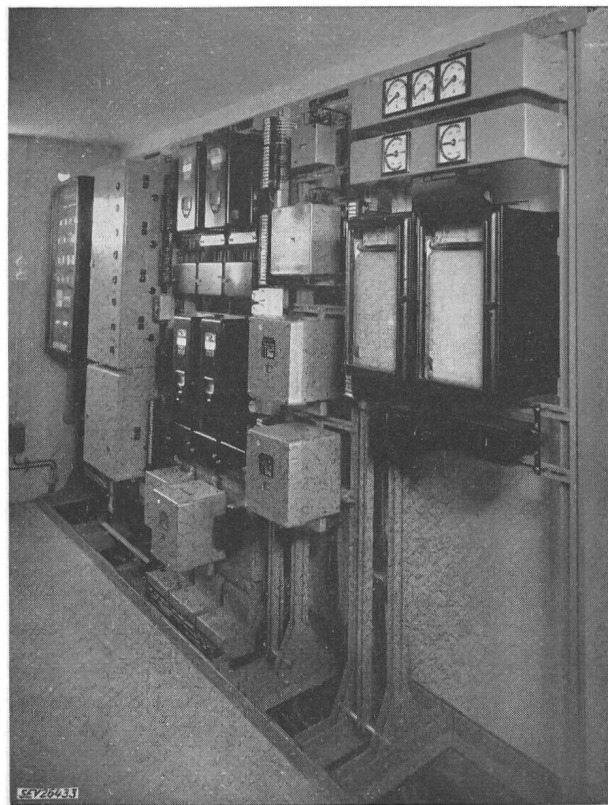
Fig. 9 Relaisstation der Freiluftanlage «Kaisterfeld»
