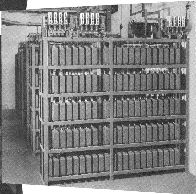
Teilansicht einer vollautomatischen Kondensatorenanlage in einer Grossglesserei
