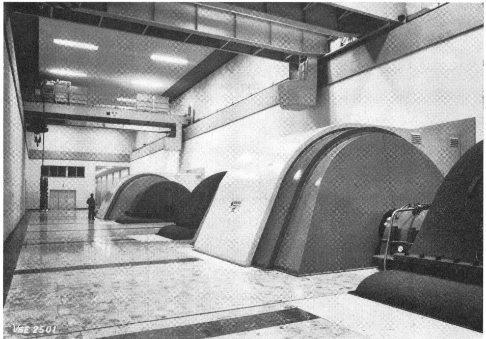
Fig. 2 Die Kavernenzentrale Stalden
