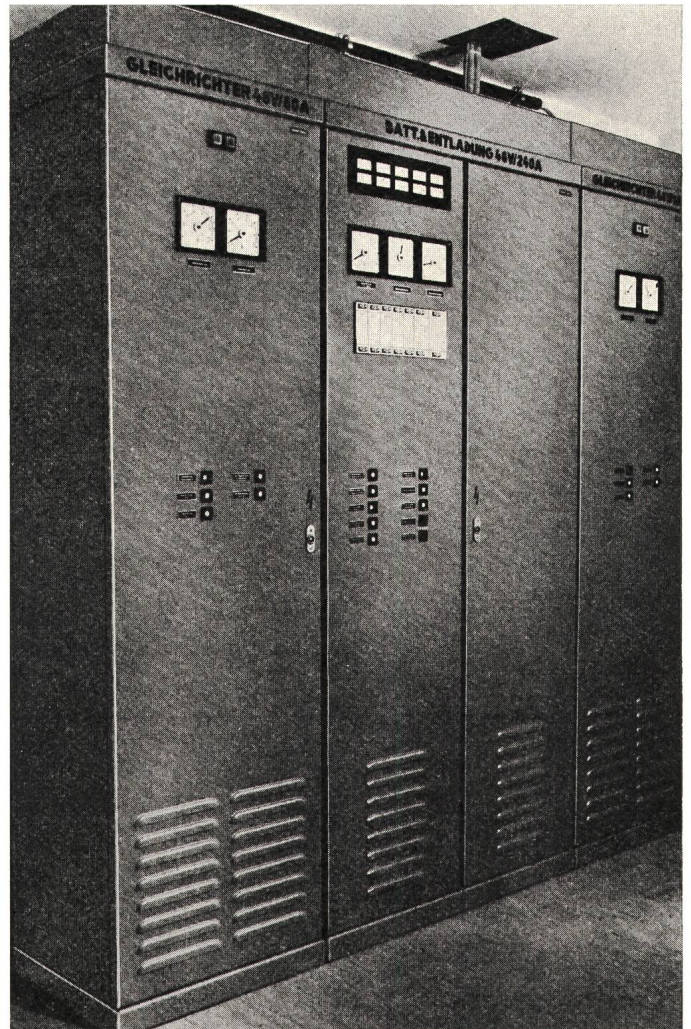
Fig. 7 Stromversorgungsanlage 48 V/Typ 240 A mit Gleichrichtern von 60 A
