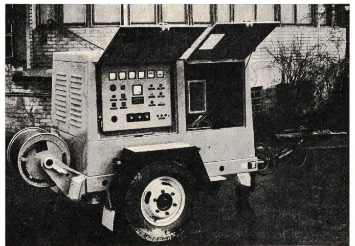
Fig. 2 Mobiles Notstromaggregat von 20 kVA
