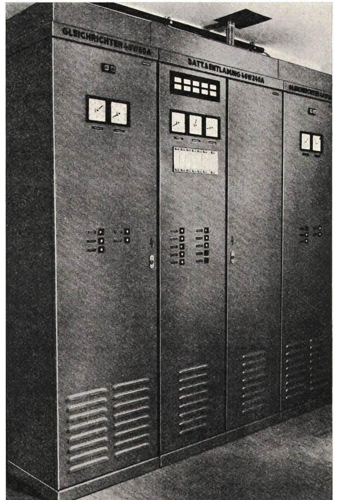
Fig. 7 Stromversorgungsanlage 48 V/Typ 240 A mit Gleichrichtern von 60 A
