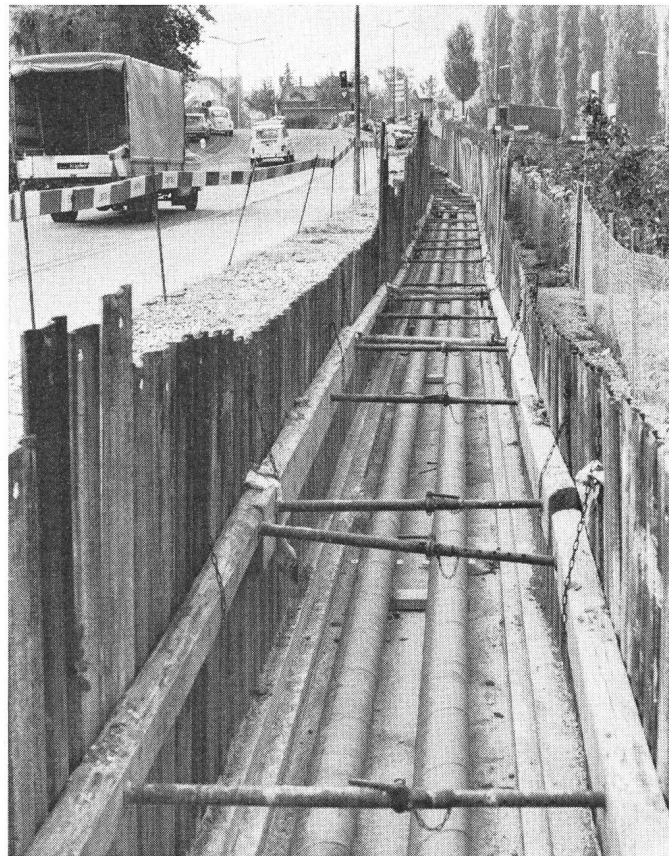
Fernwärmekanal in der Tramstrasse, Zürich
