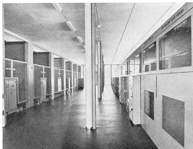
Fig. 8 L'intérieur de la sous-station 50/16 kV de Cadenazzo
