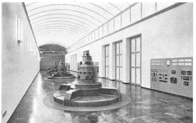
Fig. 4 Maschinensaal der Kraftwerkzentrale Verbano I
