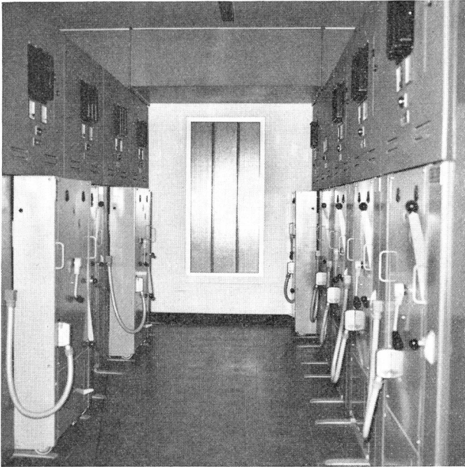
Fig. 1 16-kV-Feeder im Unterwerk Monteceneri
