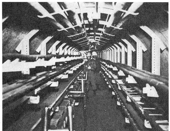
Fig. 2 165-kV-Kabel in einem Mehrzweckschacht
