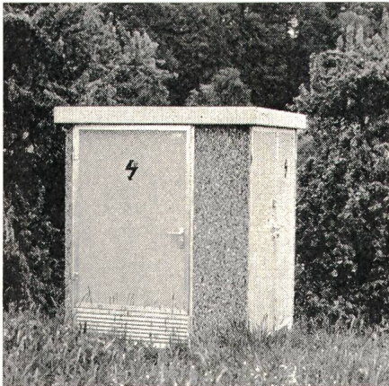
Beispiel 1: Trafostation Typ Säntis 1
