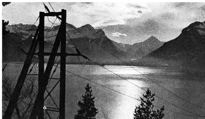
Fig. 1 15-kV-Leitung Seelisberg, Abspanngestänge
