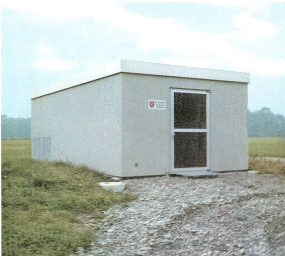
Überflur-Trafostation EW Lachen
