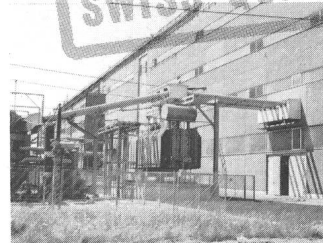
Generatorableitungen 21 kV, 13000 A
