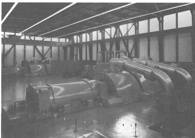
Fig. 6 Maschinensaal im Kernkraftwerk Mühleberg
