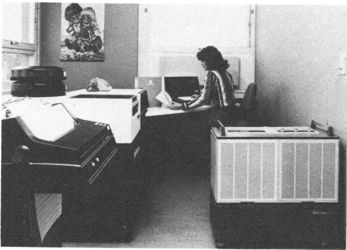
Verdunster-Luftbefeuchter in EDV-Anlage (Defensor AG)
