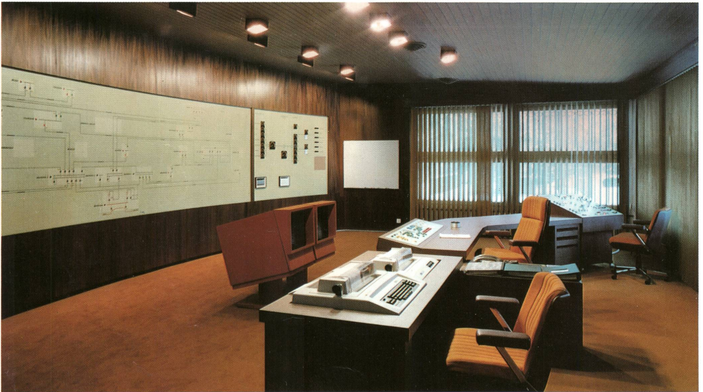
Netzleitstelle der Elektrizitätswerke Freiburg
