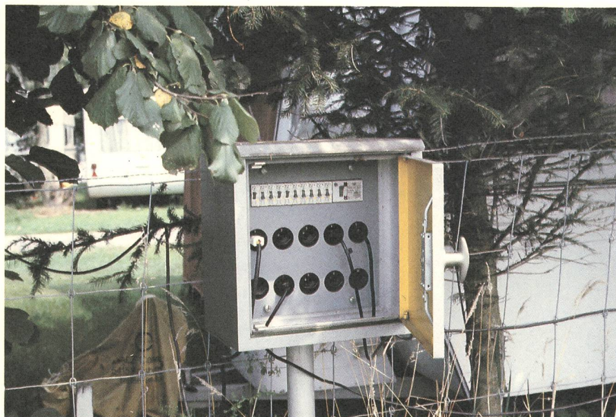
Coffret d'alimentation pour place de camping avec disjoncteur de protection à courant de défaut, et disjoncteurs contre les courts-circuits
