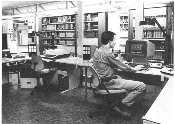
Fig. 1 Testzentrale AXE 10 der Hasler AG in Bern
