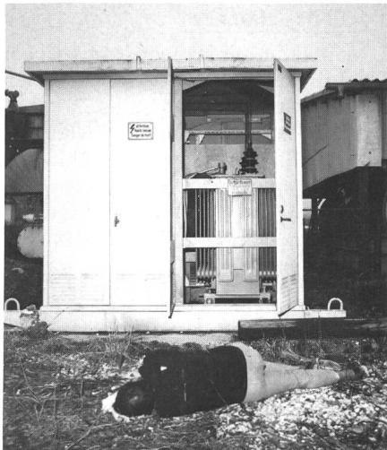
Fig. 9 Verunfallter Monteur vor der Trafokabine
