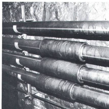
Figur 8 Kabel-Rohrblockanlage mit Muffenstelle im Albulatunnel
