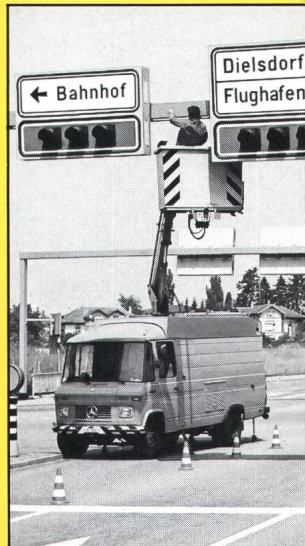
Korrosionsschutz an Signalanlagen
