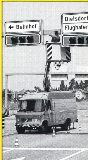
Korrosionsschutz an Signalanlagen
