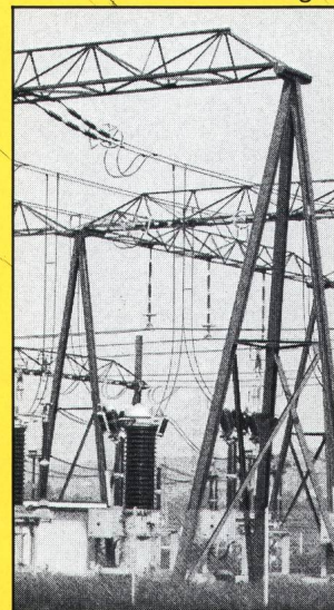
Korrosionsschutz an Schaltanlagen
