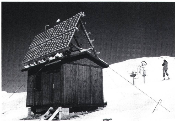
Figur 1 Photovoltaikanlage mit einer Spitzenleistung von 1,2 kW
