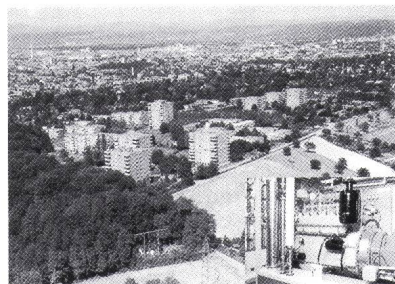
Eine Wärme-Kraft-Kopplungsanlage der Elektra Birseck Münchenstein versorgt die Überbauung Holeeholzacker BL mit Wärme.
