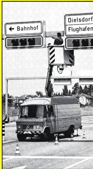
Korrosionsschutz an Signalanlagen
