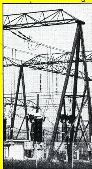
Korrosionsschutz an Schaltanlagen
