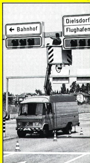
Korrosionsschutz an Signalanlagen
