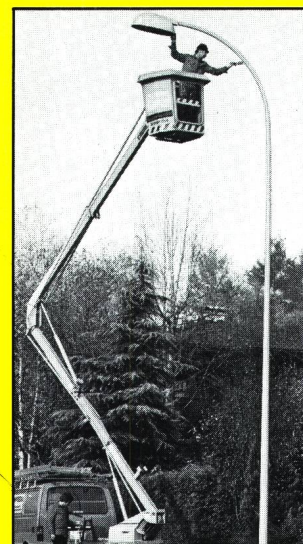
Korrosionsschutz an Stahlkandelabern
