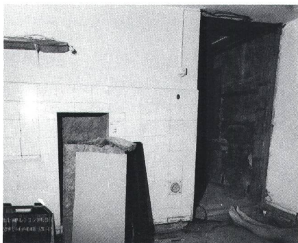
Figur 10 Unerlaubte, fehlerhafte Laieninstallation tötete einen Heizungsmonteure
