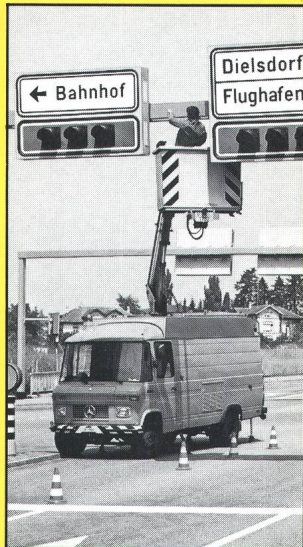
Korrosionsschutz an Signalanlagen
