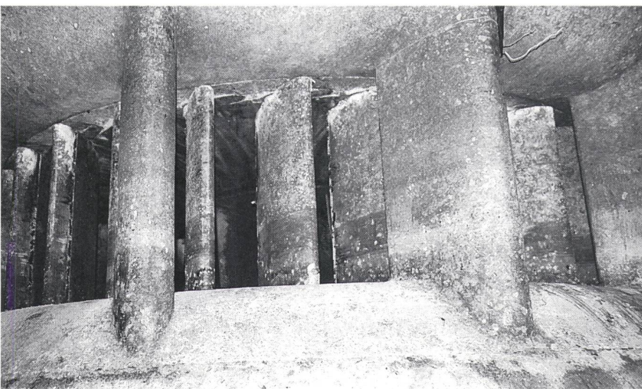
Blick von der Einlaufspirale auf den Leitapparat einer Francisturbine des Kraftwerkes Mühleberg während der Revision
