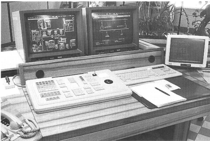
Bild 8 Netzleitstelle in der Zentrale Lütschental
