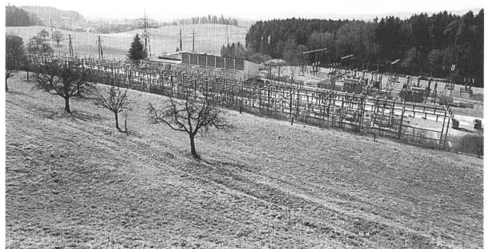
Gemeinsame Freiluftschaltanlage NOK/EKZ in Aathal. Die in Höchstspannung angelieferte elektrische Energie wird für den Weitertransport auf 110, 50 oder 16 kV heruntertransformiert (Foto: EKZ)
