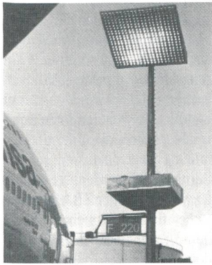
Neue Vorfeldbeleuchtung am Frankfurter Flughafen
