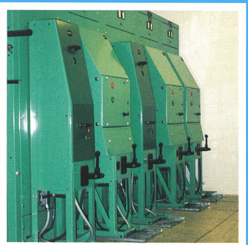
Interrupteurs et disjoncteurs Vakuum-Last- und -Leistungsschalterzellen im RhB/UW Sils
