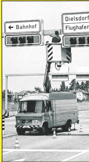
Korrosionsschutz an Signalanlagen
