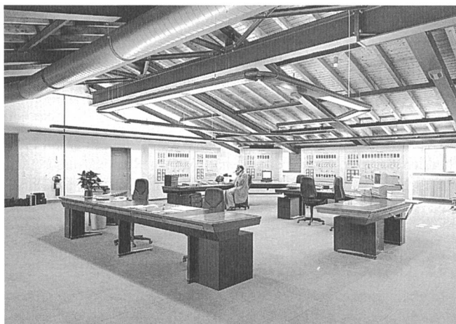
Mit dem Umzug der regionalen Leitstelle ins Dachgeschoss des UW-Neubaus in Altstetten konnte der Anlagenüberblick und die Arbeitsplatzbedingungen der Disponenten wesentlich verbessert werden
