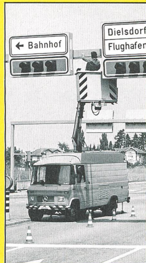
Korrosionsschutz an Signalanlagen
