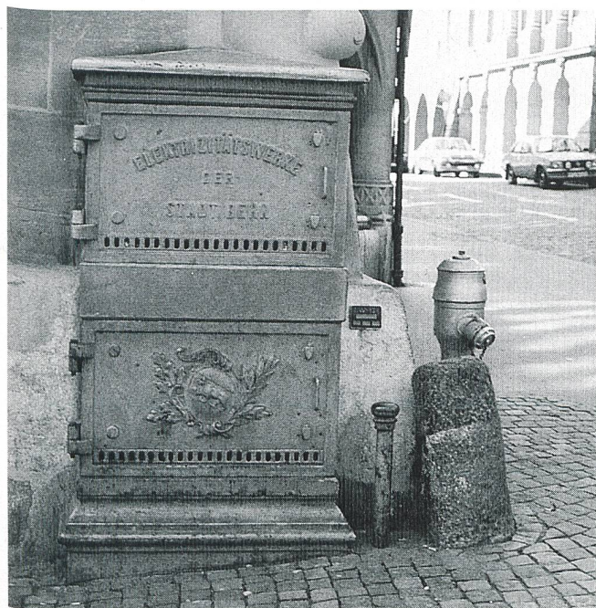
Bild 5 Im Innern der Städte wurden die Stromleitungen von Anfang an unsichtbar im Boden verlegt. Die dafür verwendeten oberirdischen Abzweig- und Sicherungskasten sind meist besonders sorgfältig entworfen worden. In Stahl gegossen erhielten sie neben der Bezeichnung Elektrizitätswerk auch Stadtwappen und Namen. Als wichtige Zeugen der Elektrifizierung sind sie in Ortsgeschichten zu dokumentieren und in Ortmuseen, wie andere wichtigen Artefakte auch, zu sammeln (Bern)
