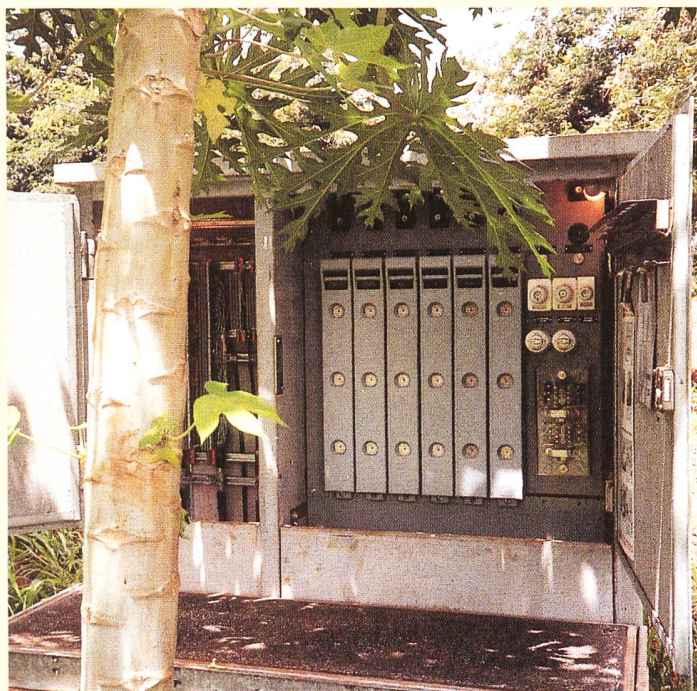
Kabelverteilkabine Gr. II, TV-Typ C
