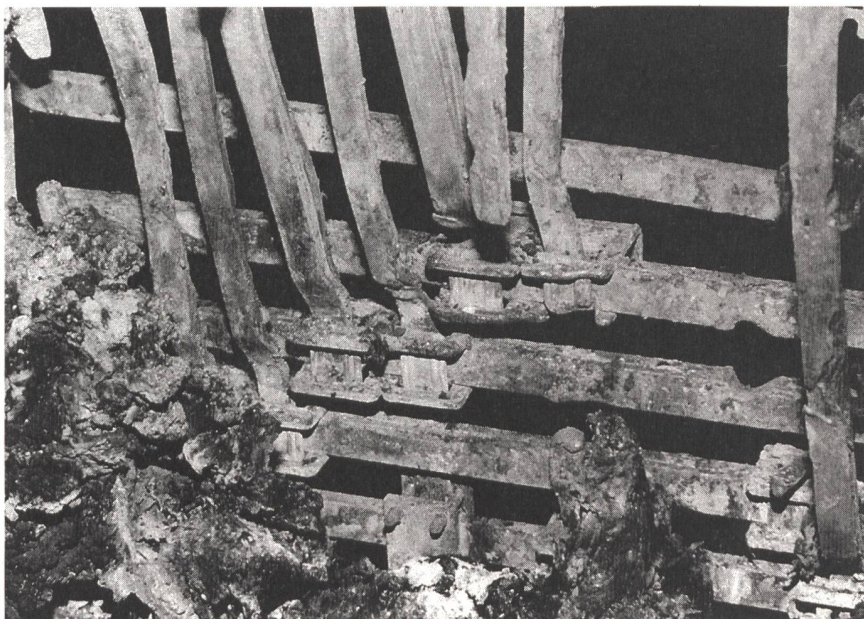
Bild 1 Ein durch Überlast zerstörter Niederspannungsverteiler
