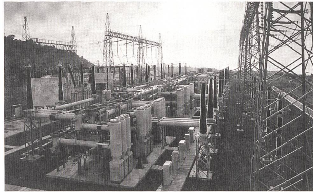
Gekapselte, SF 6 -isolierte Schaltanlage für 500 kV (Bild GEC Alsthom).
