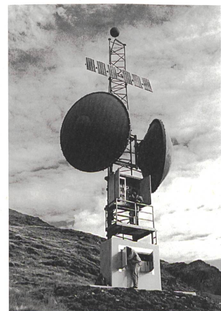
Bild 1 Stromversorgung eines isolierten Standortes
