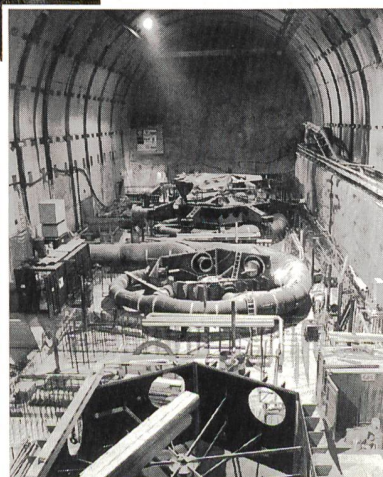
Kavernenzentrale des Kraftwerks Amsteg (UR).
