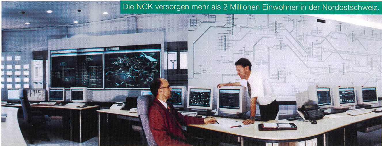
Für die neue Energie- und Netzleitstelle der NOK in Baden hat ABB das S.P.I.D.E.R.-Energiemanagement-System geliefert.
