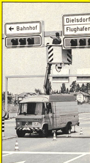
Korrosionsschutz an Signalanlagen
