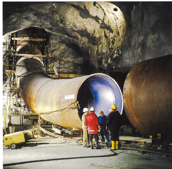
Bild 5 Der letzte Bogen der Druckleitung am Eingang zur Kraftwerkskaverne gibt einen Eindruck der Ausmasse: Bei 3,2 m Durchmesser trotz er einem Wasserdruck von 20,3 MPa.
