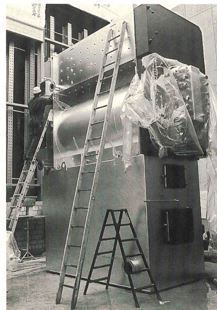
Der Holzschnitzelheizungskessel für die Nahwärmeversorgung Krummeneich Pratteln mit einem Gesamtgewicht von etwa 17 Tonnen und einer Leistung von 1200 kW wird in Pratteln installiert.
