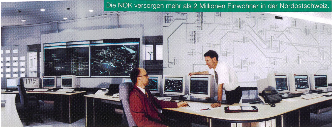
Für die neue Energie- und Netzleitstelle der NOK in Baden hat ABB das S.P.I.D.E.R.-Energiemanagement-System geliefert.
