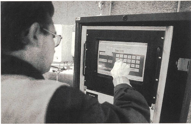
Bild 2 Blick auf einen von insgesamt sieben Tast-Bildschirmen mit denen die Beleuchtungssteuerung und die Oblichtsteuerung des gesamten Gebäudekomplexes bedient werden.
