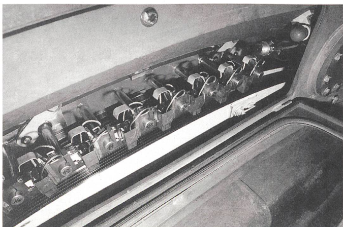
Bild 4 Blick in die geöffnete Schleifringkammer. Im Stillstand werden die Bürstenbrücken pneumatisch vom Schleifring abgehoben.
