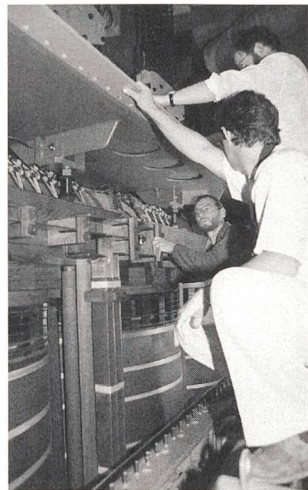
Figura 3 Ispezione del trasformatore.
