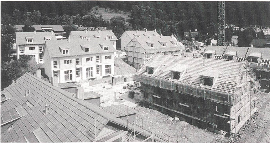
Für Mehrfamilienhäuser und ganze Überbauungen übernehmen die EKZ das Wärme-Contracting. Diese Überbauung in Sellenbüren bezieht Warmwasser für Heizung, Bad und Küche ab einer zentralen Wärmepumpenheizung zu vertraglich festgelegten Preisen. Bau, Betrieb und Unterhalt der Heizung übernehmen die EKZ.
